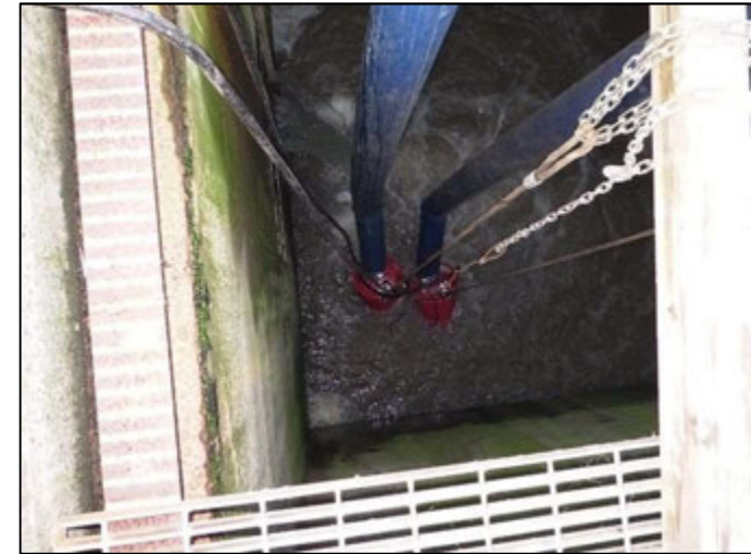
ポンプ稼働状況 (8インチ×2台)
