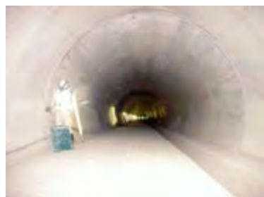
千田雨水1号幹線 (直径 5.75m、延長 2.2km)
