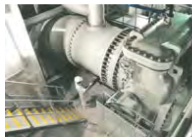
新千田ポンプ場 (排水ポンプ:口径 2.0m)
