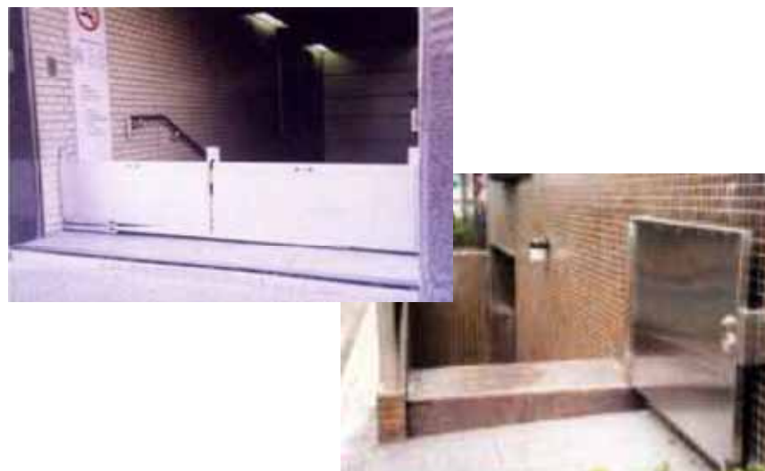
地下施設入口への止水板の設置事例
